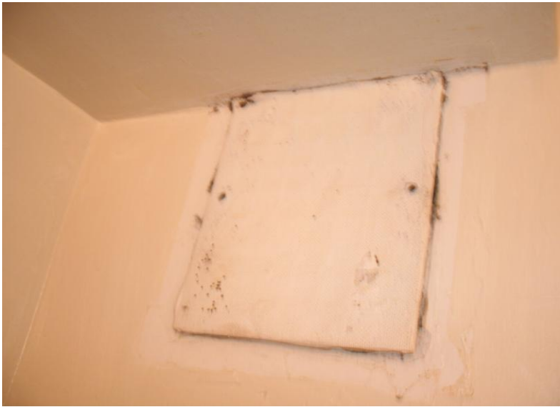
Tenant Blocked Vent
